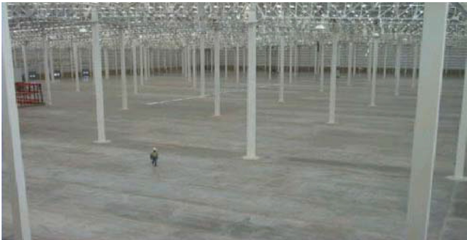
Stabilimento Nestlé in Cile cosiddetto “La casa de piedra”: 400.000 m 2 di pavimento posteso.
