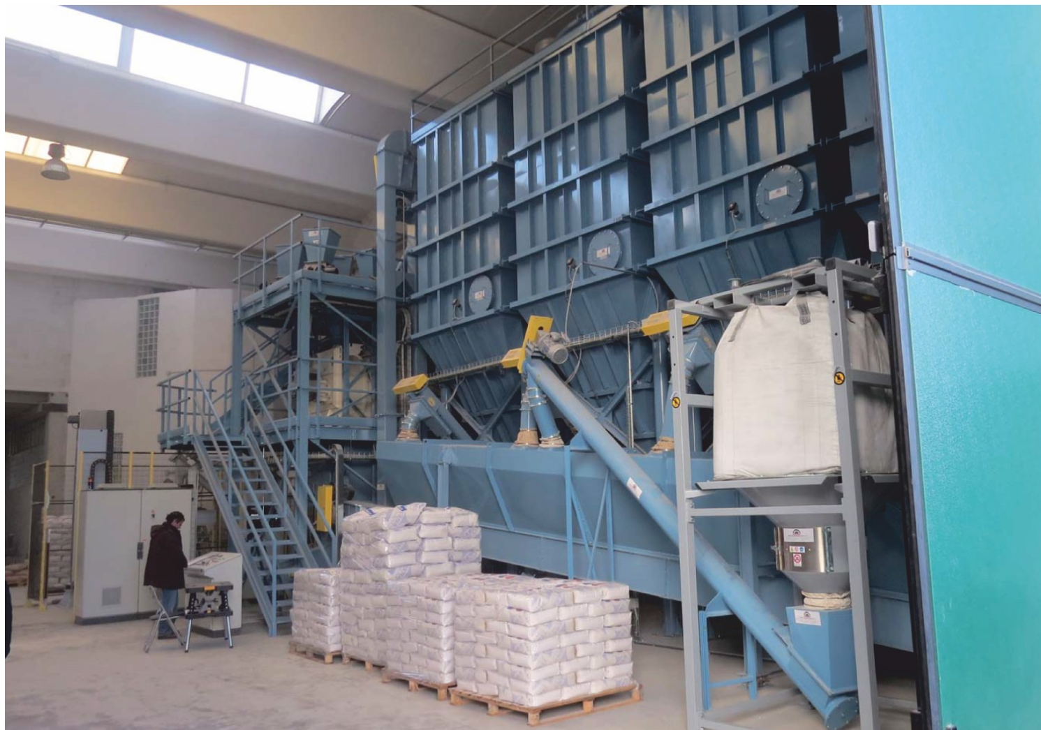
Impianto per la produzione di malte e prodotti per pavimenti industriali.
