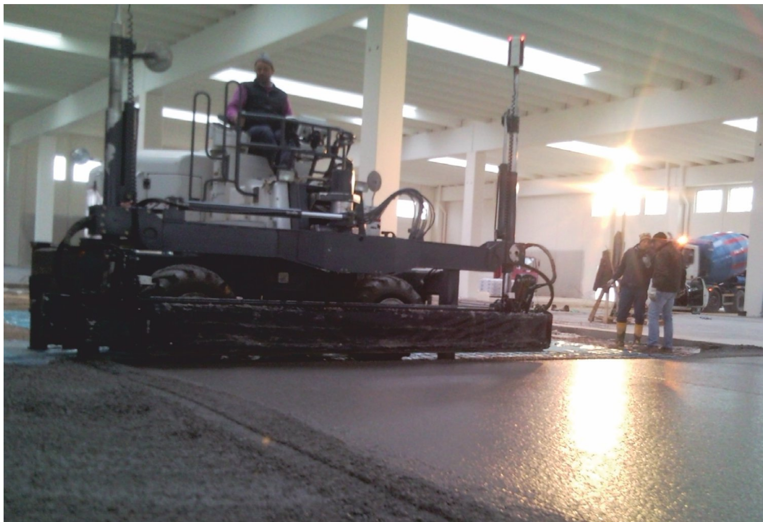
Committente Teknopavi Group, cantiere Leroy Merlin, calcestruzzo fornito da Calcestruzzi Zillo, assistenza IIC.
