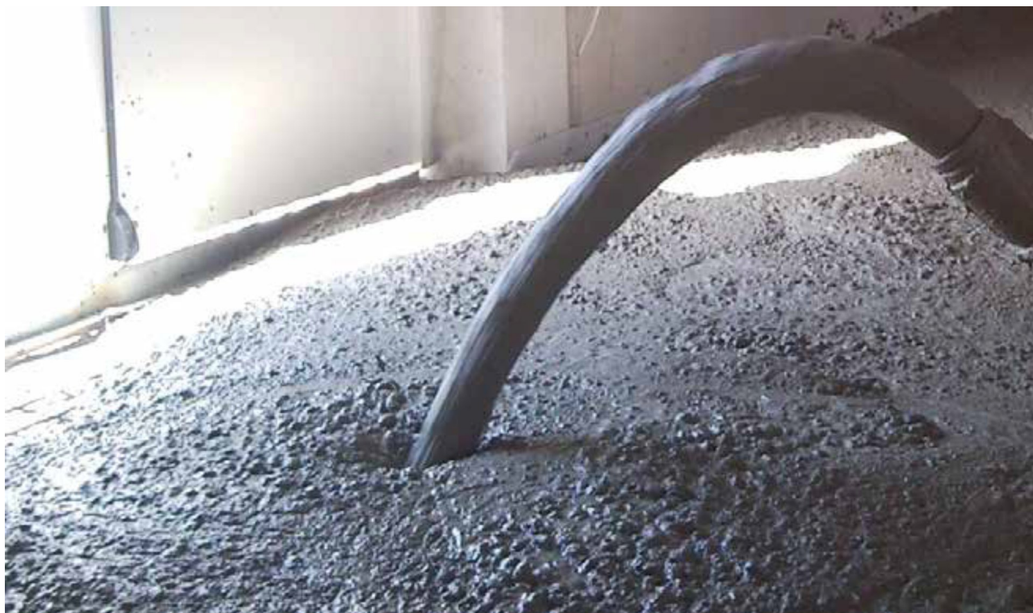
L'Aeternum CAL impiegato per i lavori di rifacimento delle sponde del Canale Villoresi, a Monza.
