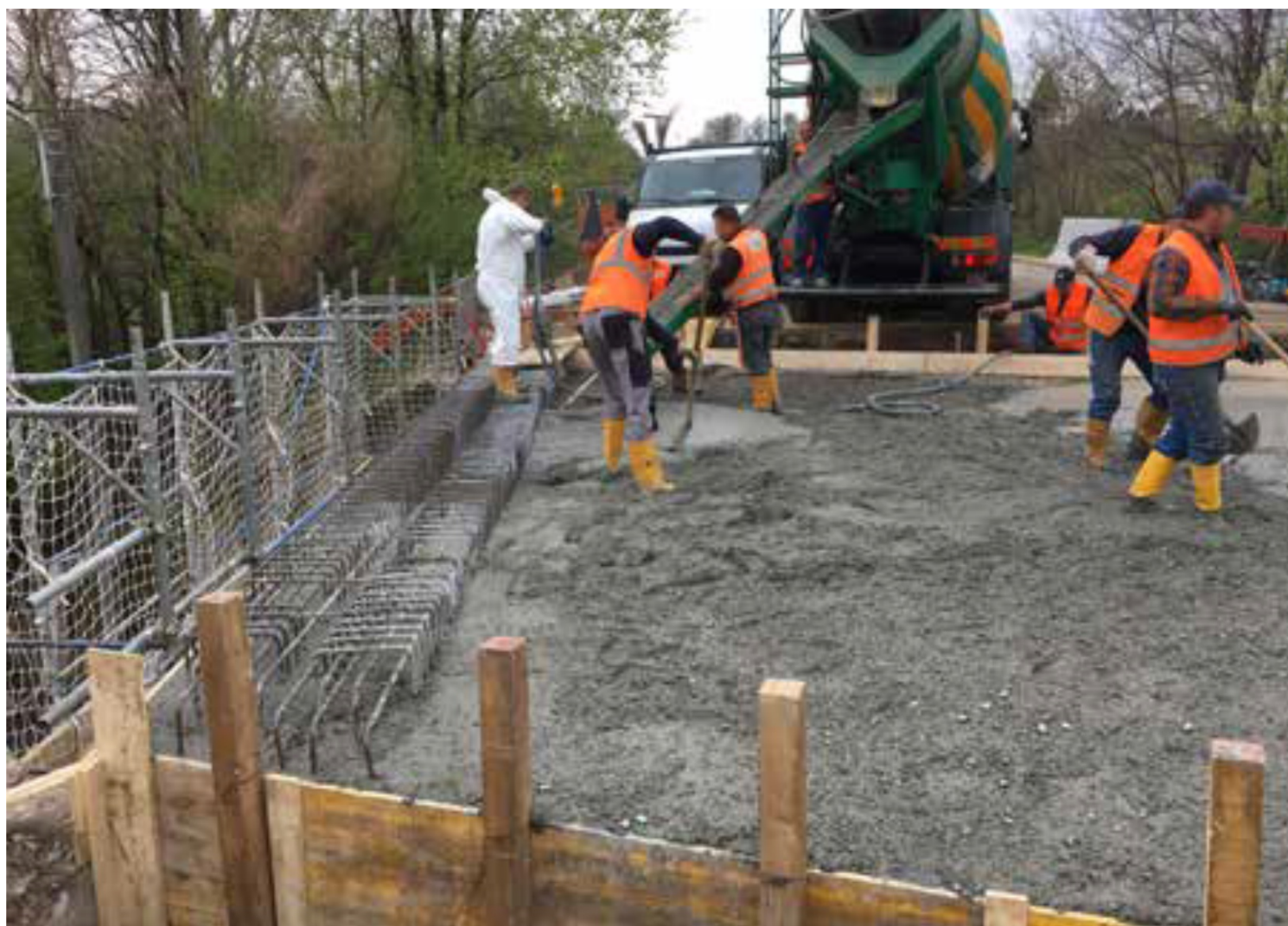
Posa in opera di calcestruzzo "eterno" in una riqualificazione di un ponte stradale
