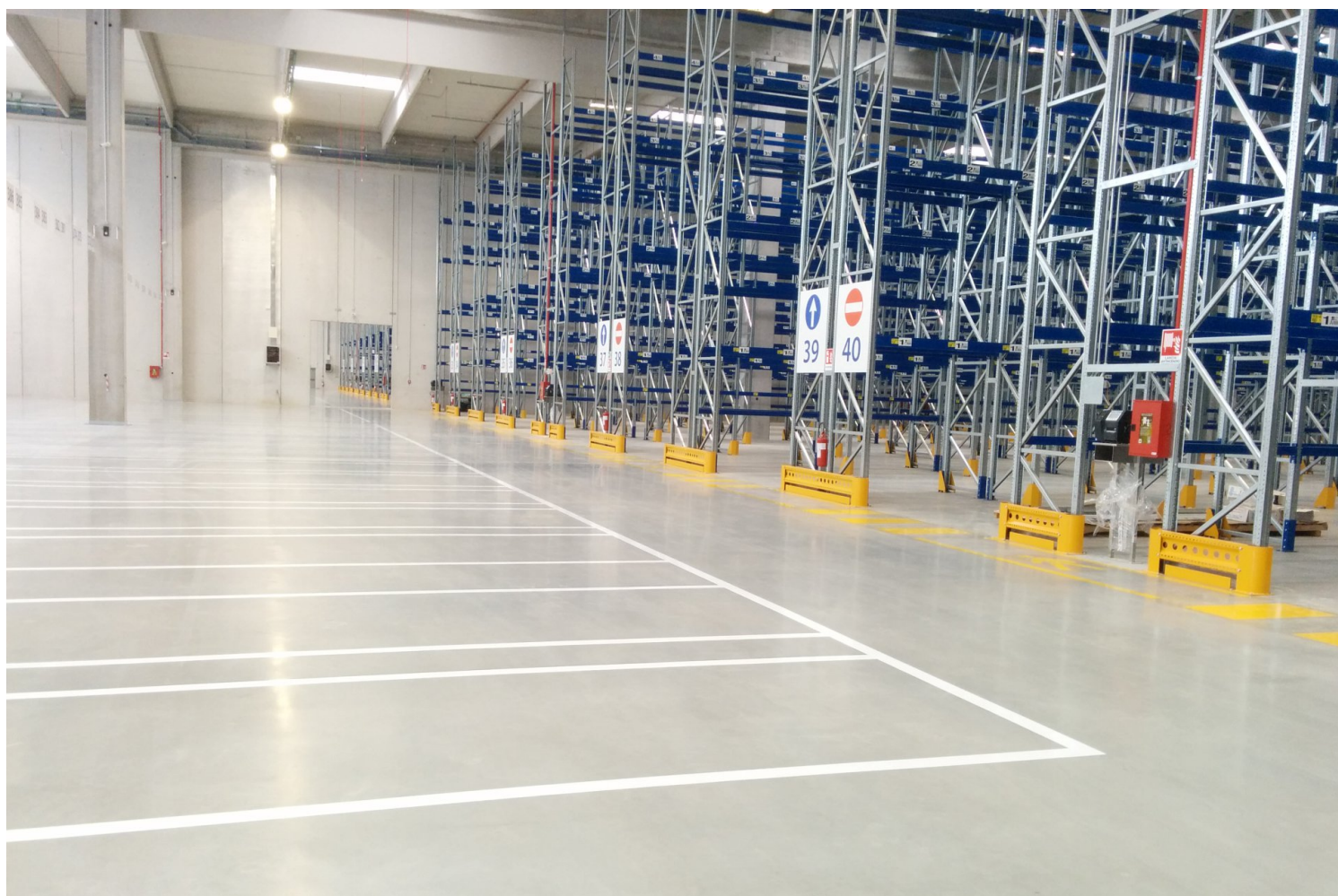
Pavimento industriale praticamente "eterno"...
